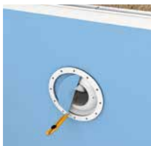
Étanchéité au droit du projecteur.
