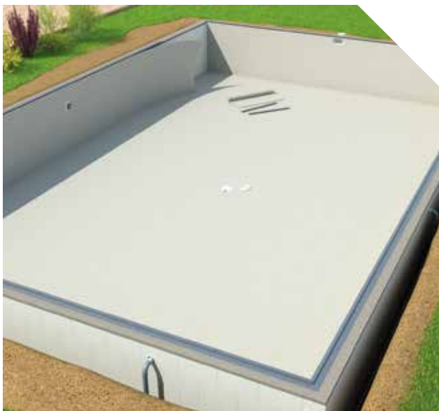
Mise en place du feutre de protection et fixation du rail de liner sur l'arase.
