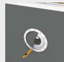
Étanchéité au droit du projecteur.
